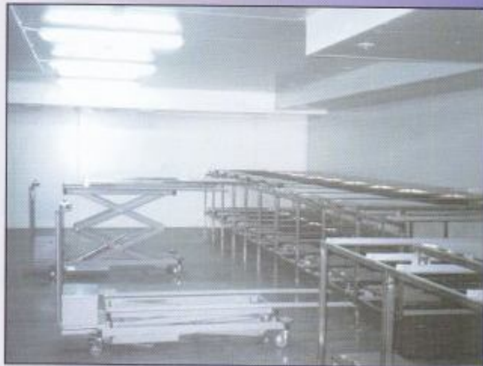
Miejska chłodnia na Cmentarzu Komunalnym Południowym w Warszawie: stelaże do przechowywania trumien i wózki - podnośniki
